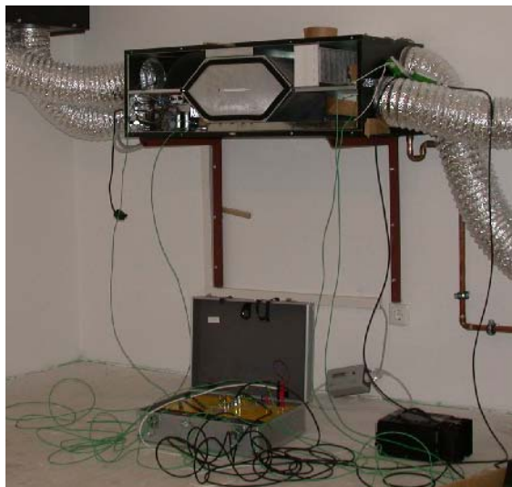
Abbildung 3.4: Messaufbau am Lüftungsgerät – keine Möglichkeit der Fühlerpositionierung in den flexiblen Luftsträngen
