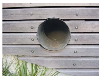
Abbildung 3.54 a-b: Ein stark verschmutztes Fliegengitter erzeugte einen Druckverlust von über 180 Pa und deutlich unausgeglichene Volumenströme. (Anlage war an der Leistungsgrenze.)
