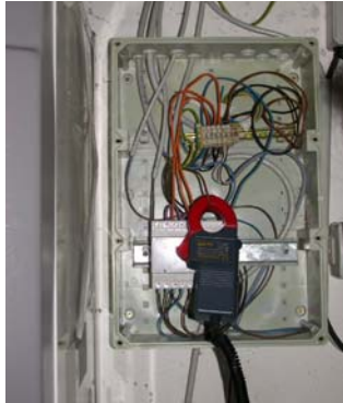
Abbildung 3.5: Strommessung mit Zangenamperemeter
