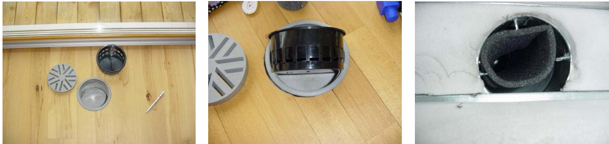
Abbildung 3.134 a-c: Bodenauslass mit einem unprofessionellen Versuch der Schallreduktion
