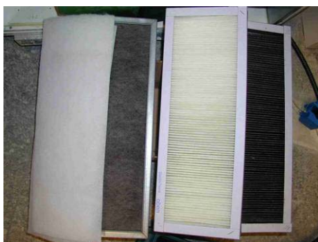
Abbildung 3.97: Filtermatte (Abluft) bzw. Kassettenfilter (Zuluft) jeweils neu bzw. verschmutzt.
