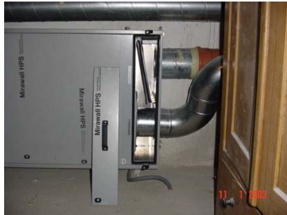
Abbildung 8.4: Frischluft bzw. Fortluftanschlüsse und provisorischer Kondensatabfuhr
