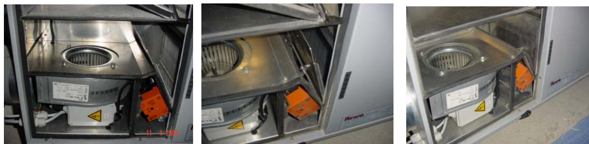
Abbildung 3.105 a-c: Automatische Bypassklappe: geschlossen – halboffen - offen
