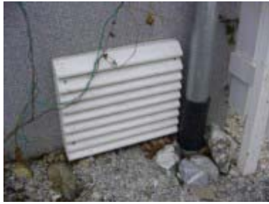
Abbildung 3.61: Ofen ohne eigene Zuluft im Wohnzimmer Mangelhafte Frischluftansaugung: Direkt am Boden, neben dem Parkplatz, und mit dicken Lamellen, die den Rohrquerschnitt versperren und so einen hohen Druckverlust verursachen.
